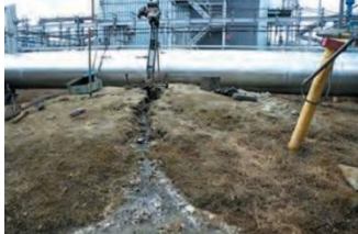
Рис. 2 - Локальный бугор пучения на площадке агрегата воздушного охлаждения газа I очереди дожимной компрессорной станции УКПГ-1В, вскрытый буровым станком [8]
